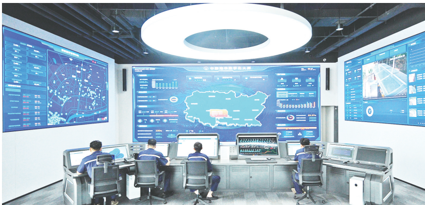
中港燃气数字化平台。
