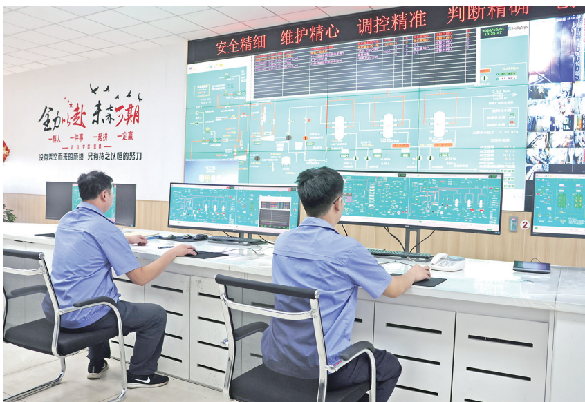
永泰源公司智慧电厂。
