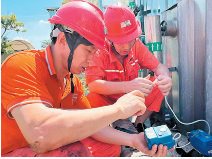
张永德与同事检测电气设备。
