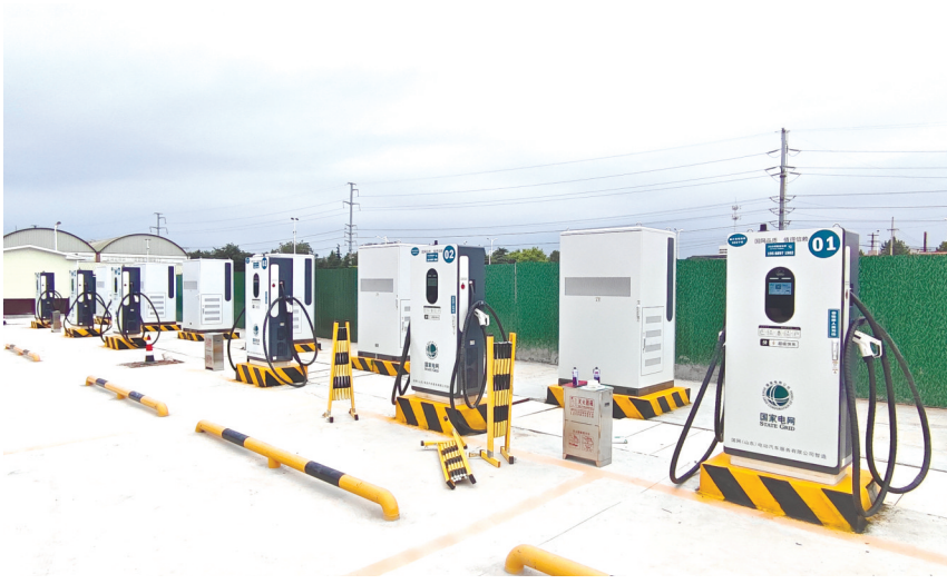
青威路电动重卡充电示范站顺利完成验收。
