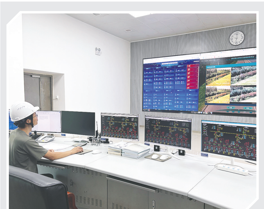
工作人员在棘洪滩水库管理站中控室密切关注水库情况。
