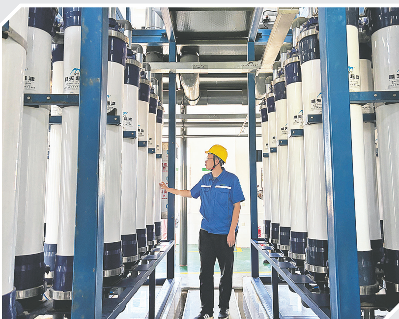
工作人员在青岛引黄济青水务集团有限公司棘洪滩水库水厂内查看设备运行情况。
