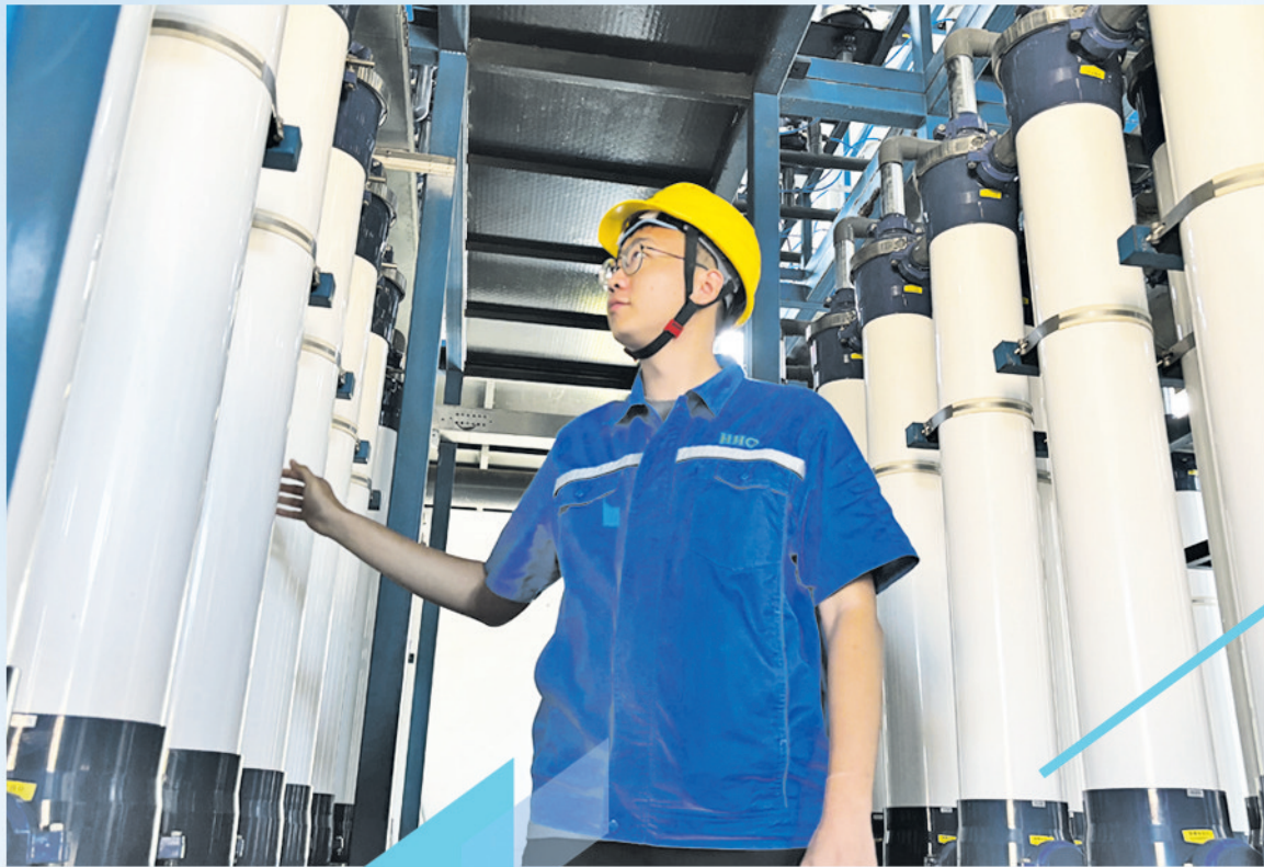
工作人员查看设备运行情况。
