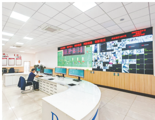
已建成的永泰源热电智慧工厂控制室。
