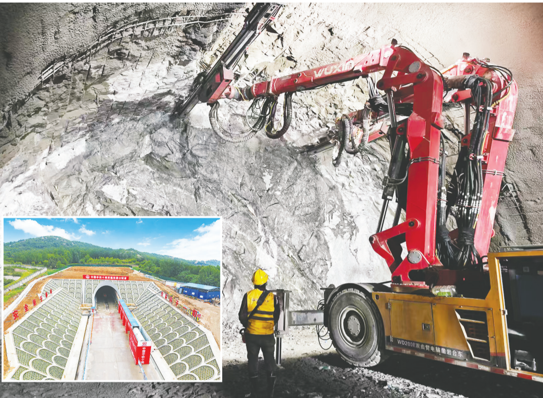
潍宿高铁至青岛连接线报屋山隧道贯通。市交通运输局供图
