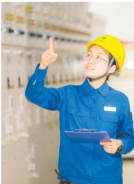
孙晓兰在变电站巡检。
