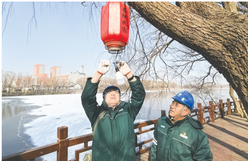
即墨区供电公司工作人员在柳林村检修民宿照明灯。
