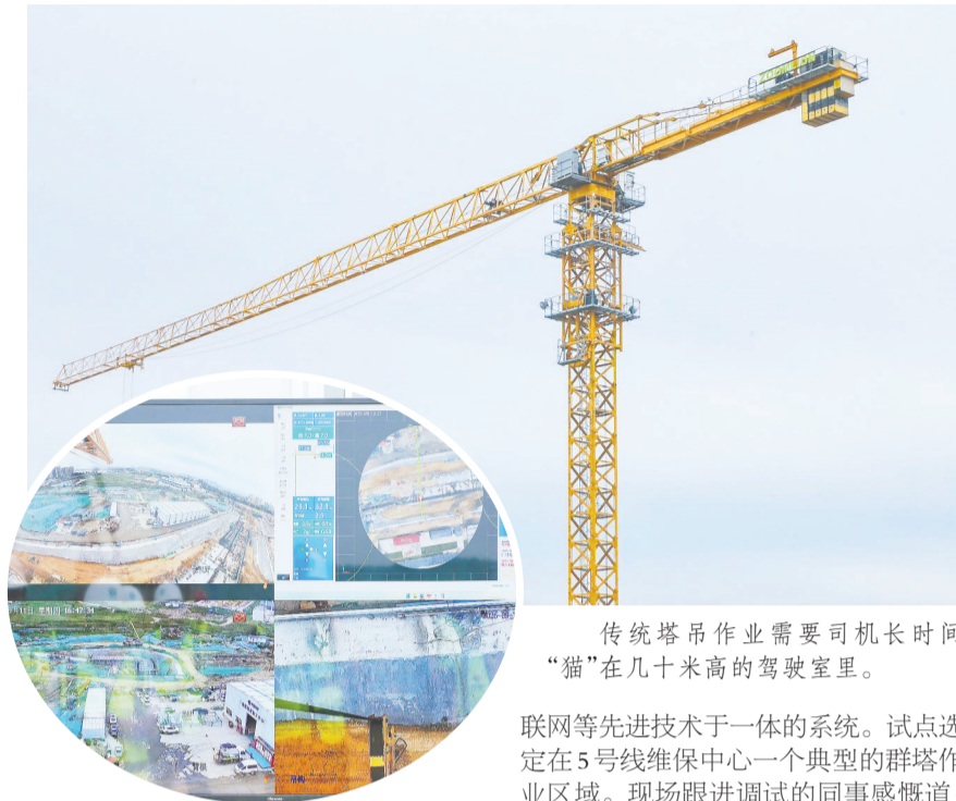
“智能塔控系统”实现在办公室塔吊控制。
