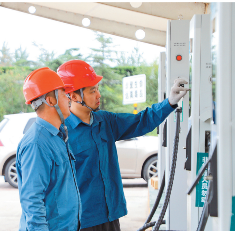
即墨区供电公司加大镇街、景区、高速服务区等充电基础设施建设力度，服务绿色出行。
