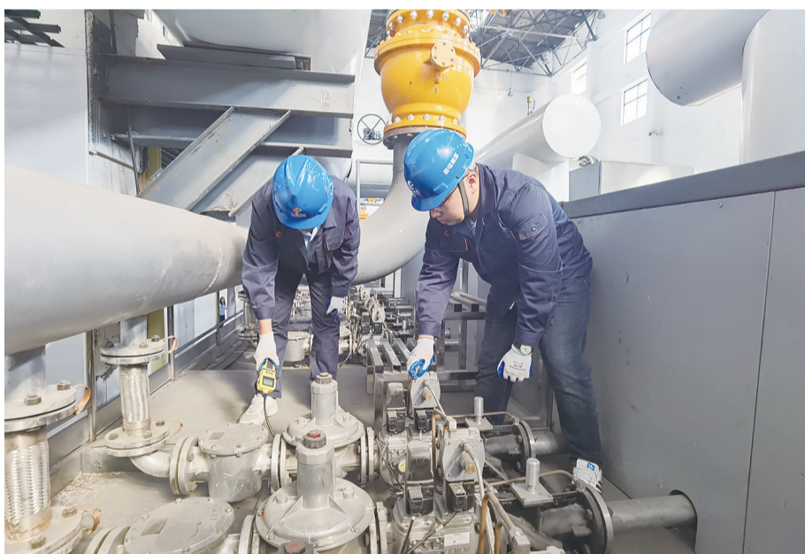
青岛能源热电集团“供热管家”对供热管网进行日常巡检。
