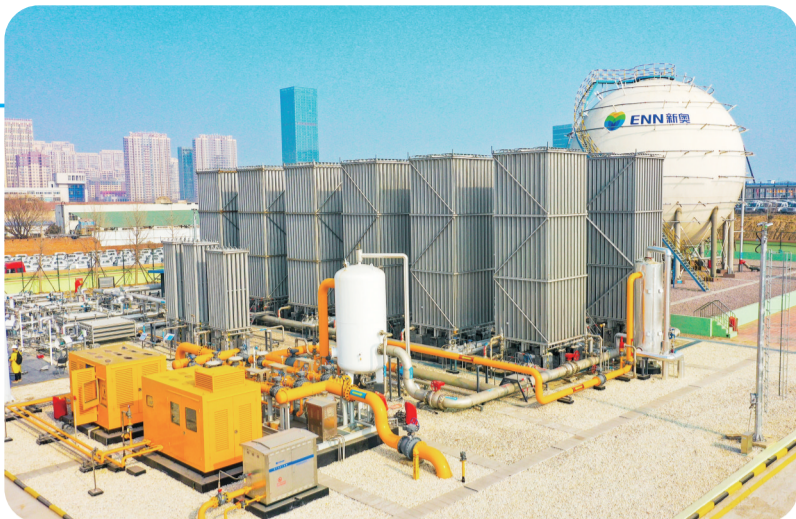
青岛新奥能源团结路门站。
