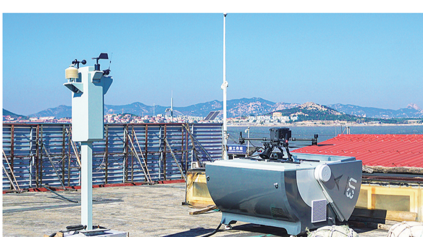
崂山区全域低空智能感知平台。崂山区电子政务和大数据中心供图
