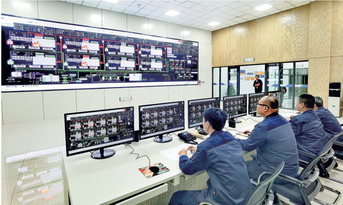
青岛能源热电集团浮新供热站供热调度指挥中心。
