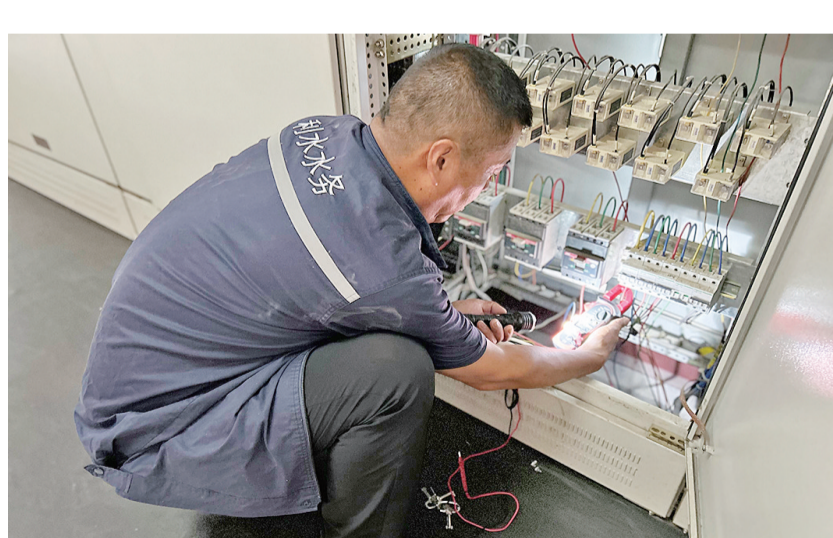
工作人员对供水机电设备进行维护。
