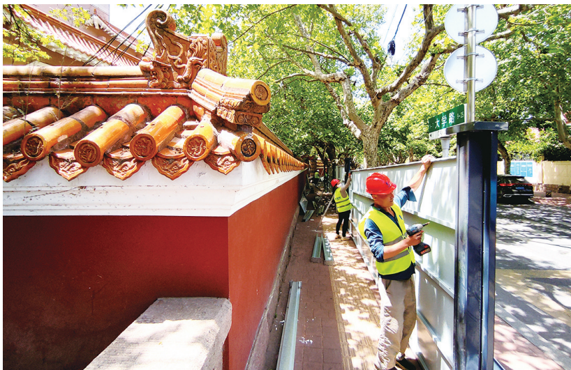
大学路网红墙启动修缮。观海新闻/青报全媒体记者 于滢 摄
