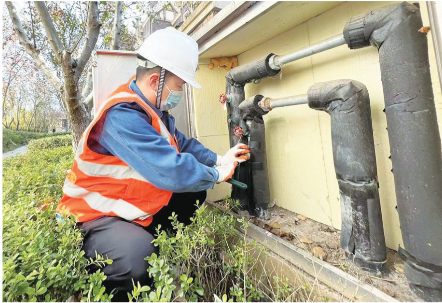
“供热管家”王亚杰在排查管道。 观海新闻/青岛早报记者 张孝鹏 摄
