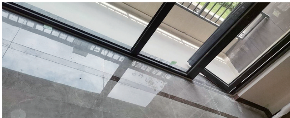
阳台落地窗里侧与地砖打胶开裂,外侧打胶粗糙。
