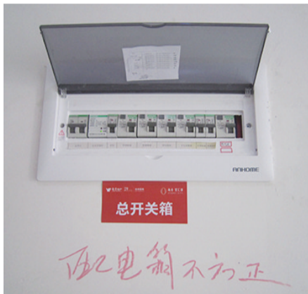
配电箱不方正。
