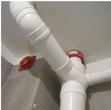
厨房已配备主下水管阻火圈设置。
