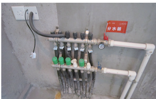
现场无给水,不具备验收给水系统和下水系统。
