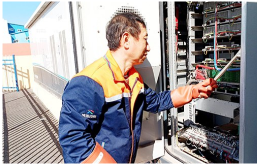
青岛城运能源科技集团开展场站设备安全巡检。城运能源科技集团供图
