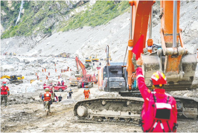
这是9月2日拍摄的吉隆泥石流灾害核心区搜救现场。新华社发
