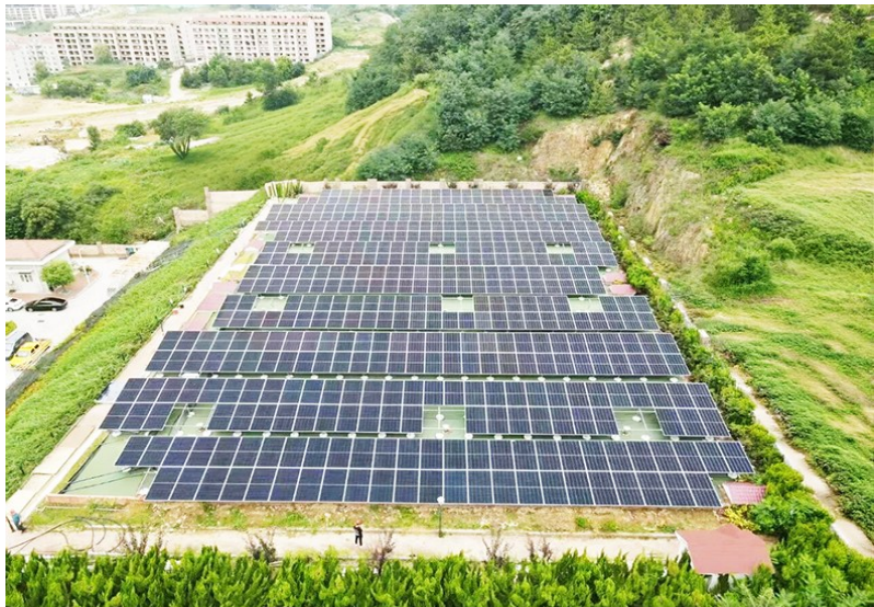
加压站光伏并网试运行让绿电惠及千万家。海润自来水集团供图
