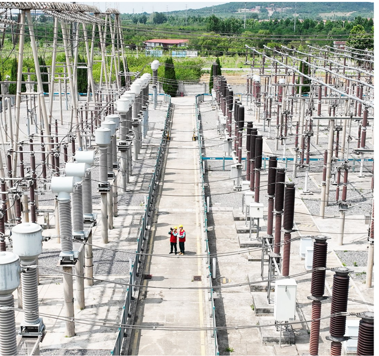
国网青岛供电公司彩虹共产党员服务队在220千伏即墨站开展油温监测和发热检查。
