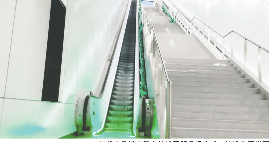
地铁8号线南段电扶梯照明升级完成。地铁集团供图
