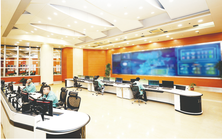
国网青岛供电公司调度控制中心值班员实时监控电网运行情况。供电公司供图
