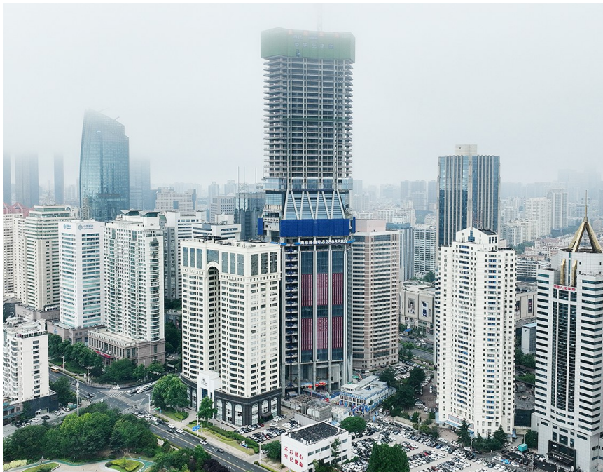
高度239.9米的航运贸易金融总部大厦项目主体结构封顶。邢志峰 摄
