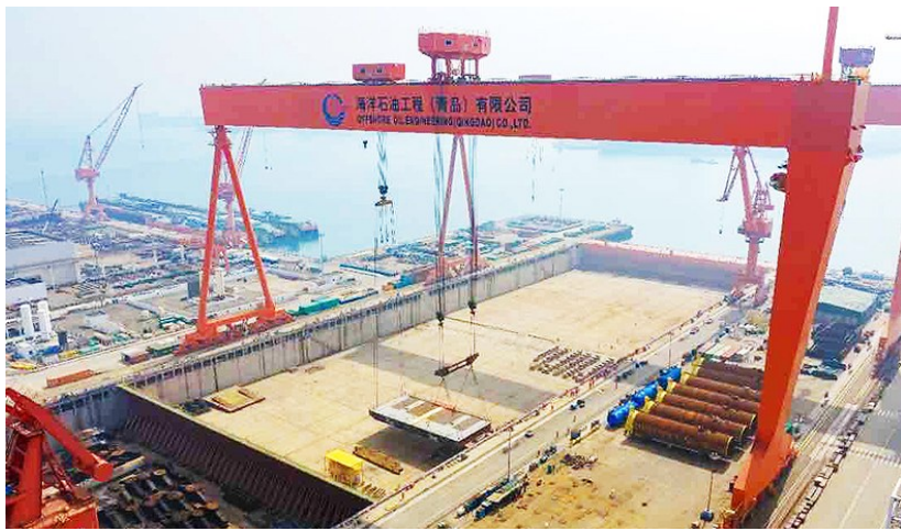
巨型龙门吊正在下放深水专业铺管船的龙骨分段。西海岸供图
