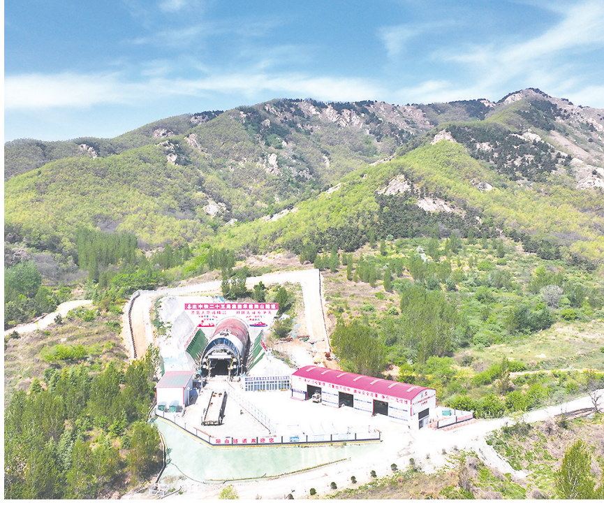
潍宿高铁至青岛连接线项目最长隧道——阳山隧道贯通。中铁二十五局供图
