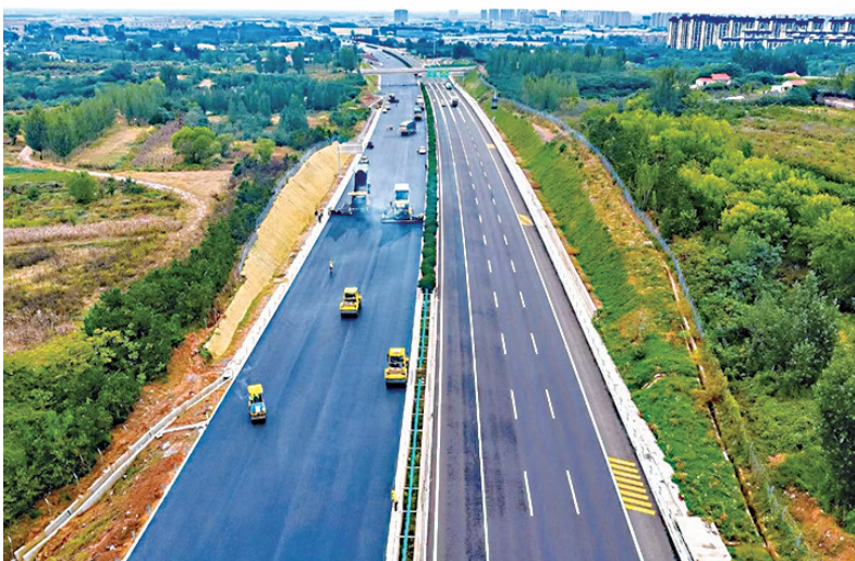
沈海高速改扩建工程部分路段即将恢复通行。交发集团供图
