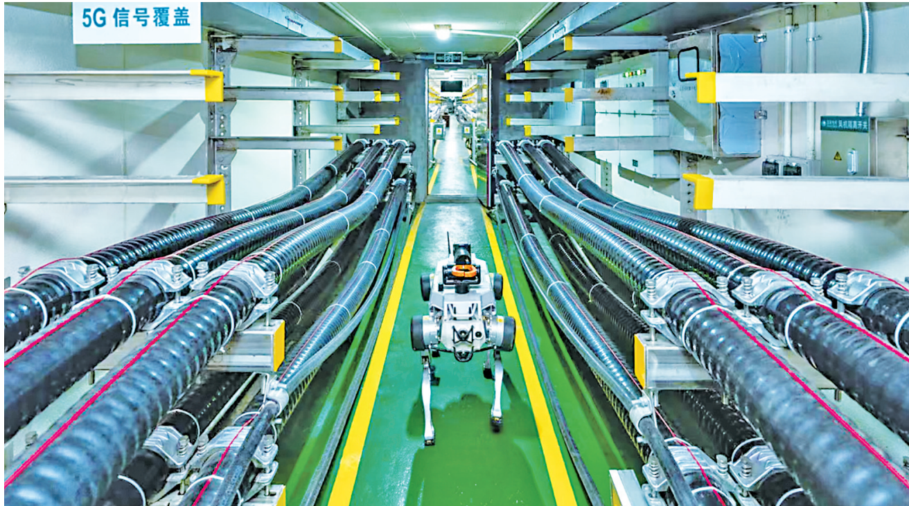
四足机器人正在对隧道内的电缆进行巡检。
