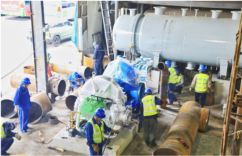
青岛能源热电集团第四热力公司换热首站进行汽动泵安装。
