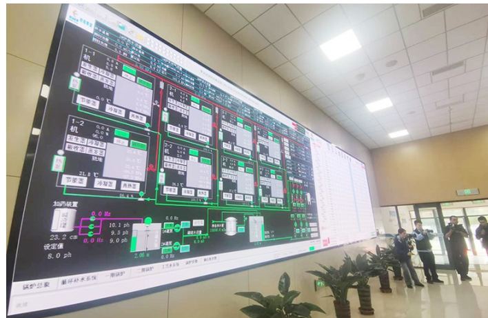
一屏尽显供热锅炉运行情况。
