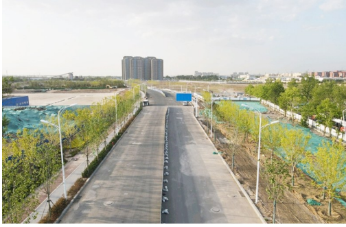
青钢片区四流北路正在进行下面层沥青摊铺、人行道铺装、乔木地被种植等施工。
