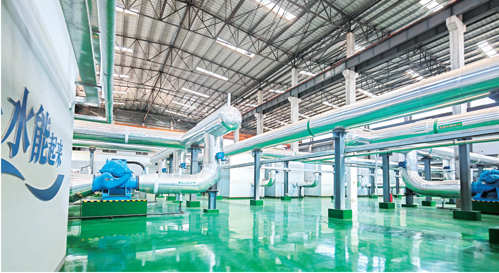
■李村河再生水清洁能源利用项目年利用再生水超2100万吨,年产热量超50万吉焦,为120余万平方米建筑供暖。
