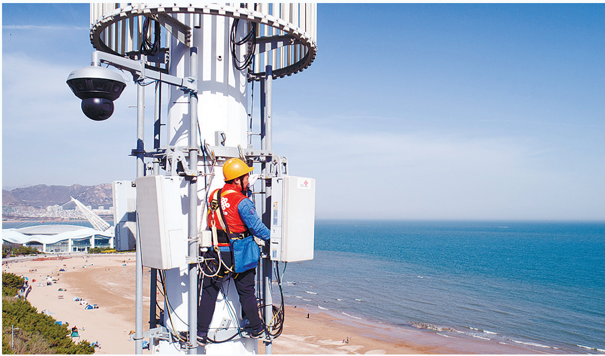
青岛联通5G基站覆盖前海一线。
