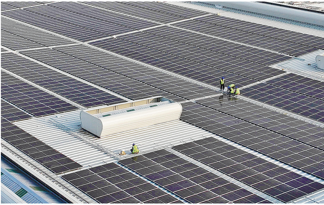
青岛工业绿色微电网发展进入“快车道”,图为城阳一家产业园区厂房屋顶铺设光伏发电板。 赵健鹏 摄
