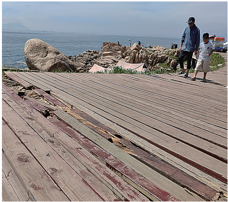
■西海岸新区鱼鸣嘴景区沿海木栈道局部破损。
