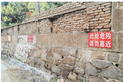
■安平路3号北侧围墙设置了警示牌。
