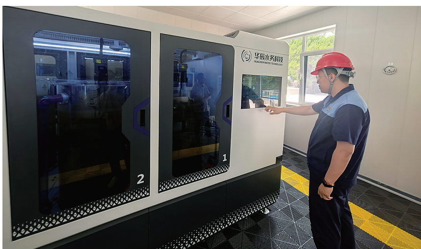
■在AI智慧系统控制室，技术人员翻看实时数据。吴帅 摄
