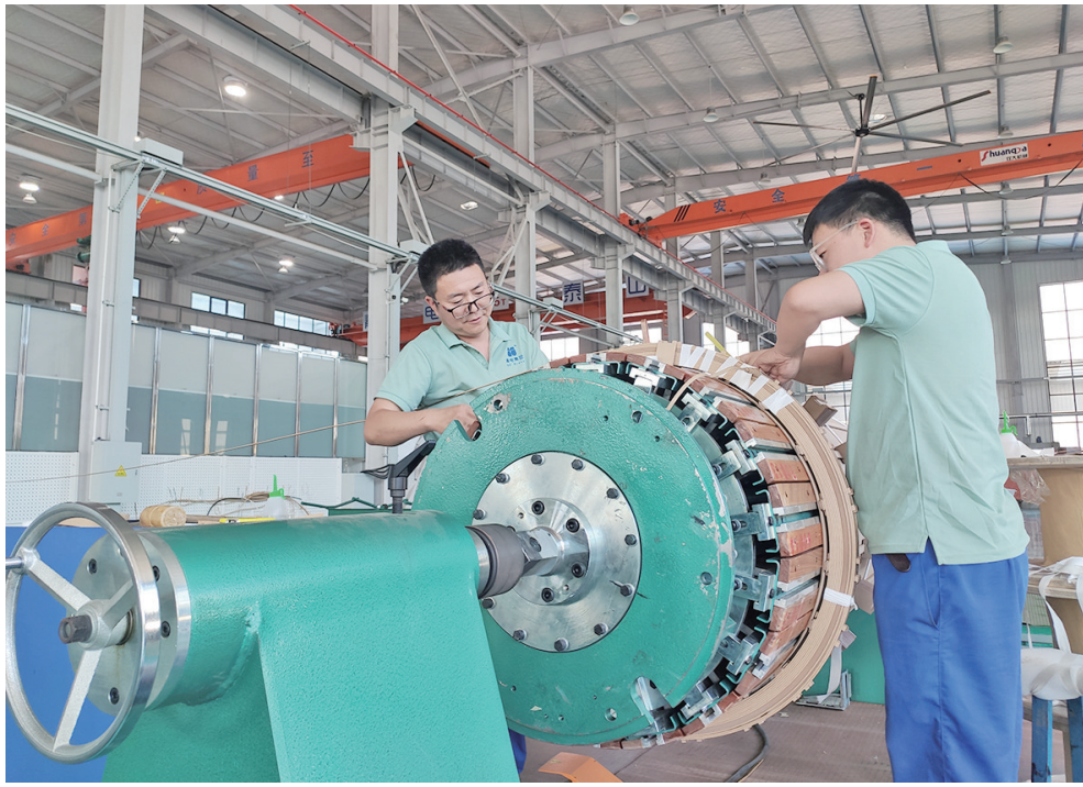
■近日,位于莱西的青岛青电变压器有限公司生产车间内,工人在调试等待出口的变压器设备。
