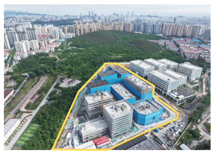
■青岛生命健康科技高端智造产业基地项目(二期)建设现场。
