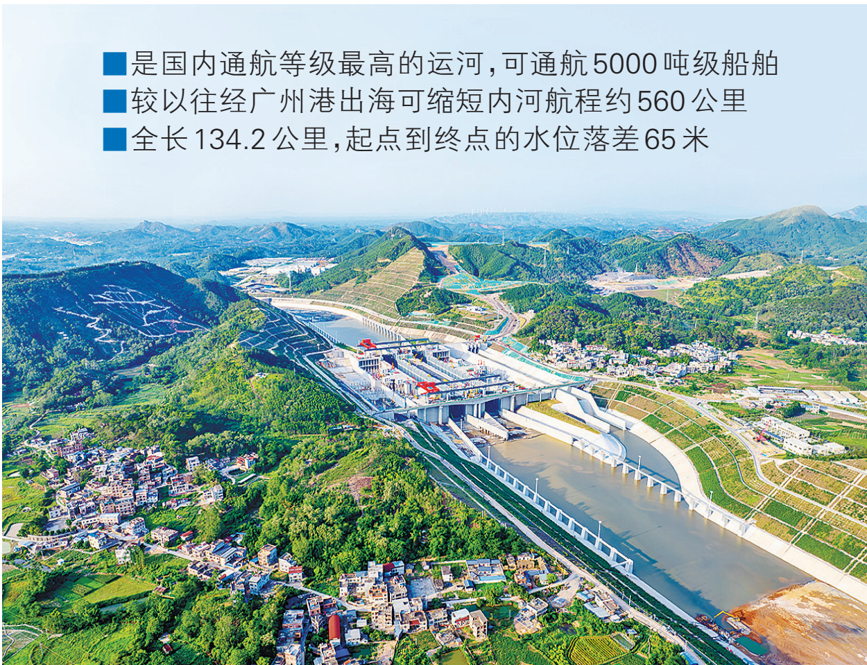
■这是6月3日拍摄的广西平陆运河马道枢纽充水现场(无人机照片)。 新华社照片
