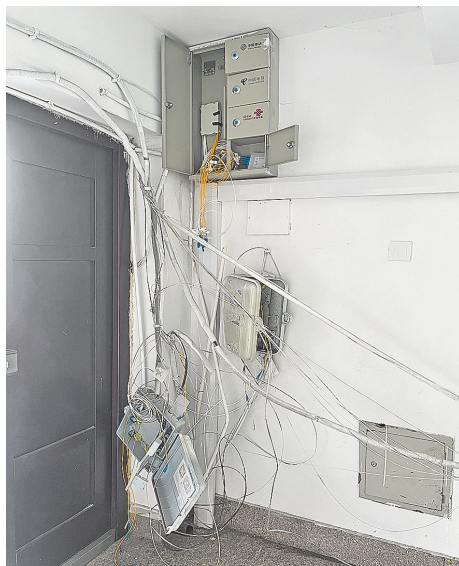
■即墨区名门世家小区4号楼楼道内线缆杂乱无章。
