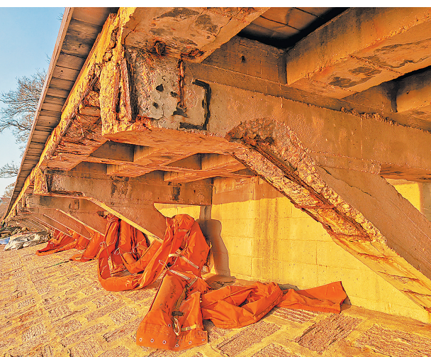
■木栈道下方底梁的水泥面层大面积脱落,露出生锈的钢筋。
