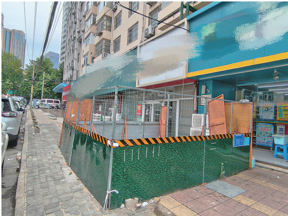
■某小区单元楼下,加装电梯项目因底商反对而停滞。
