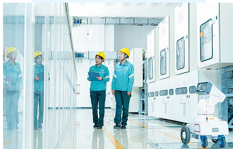
■国网青岛供电公司员工在高温高荷期间采用“人巡+机巡”的方式加强对啤酒节举办场所保电变电站的巡视。
