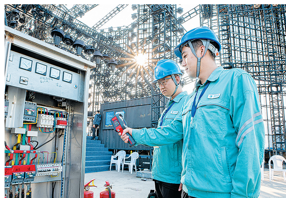
■国网青岛供电公司员工在啤酒节西海岸会场进行安全用电巡视。
