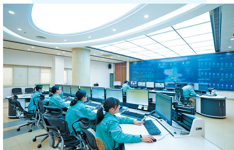
■国网青岛供电公司员工利用“低压供电可靠性态势分析平台”对啤酒节举办场所周边用电客户进行可靠性监测。
