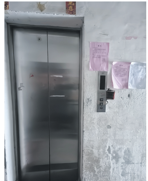
■电梯发生故障停用,旁边贴着交费通知单。
