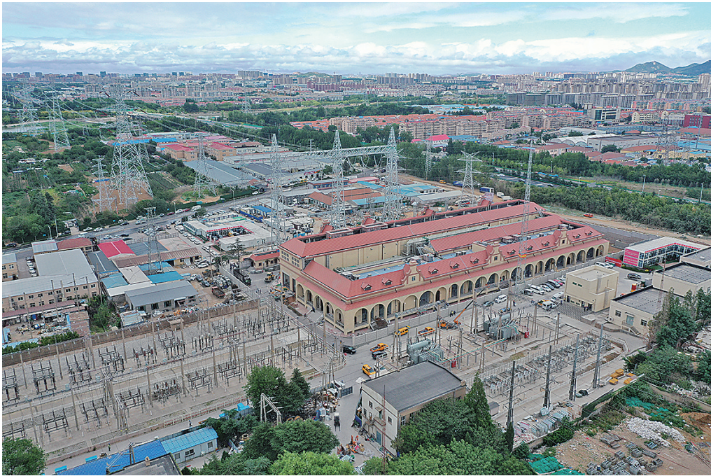
■岛城500千伏变电站建成投产。
