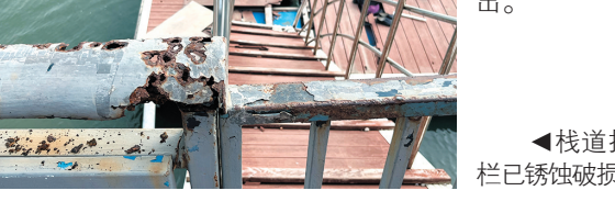
▲栈道护栏已锈蚀破损。
